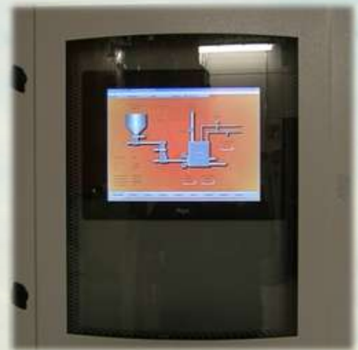
Puunjalostustehdas (hake) 1.6MW / TiiMi 7310
